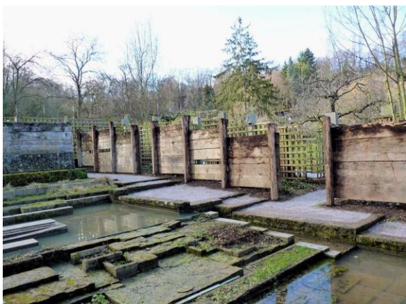
1 Innenbereich nach Befreiung von Efeu
