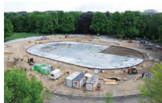
Das Betonieren ist fast abgeschlossen – deutlich ist die Form der Anlage zu erkennen.
